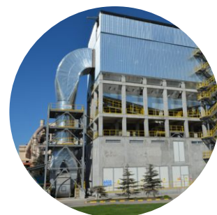
Wentylator z filtrem młynowym
