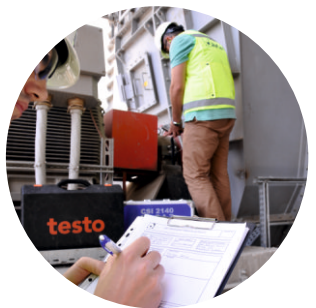
Pomiar wydajności wentylatora
